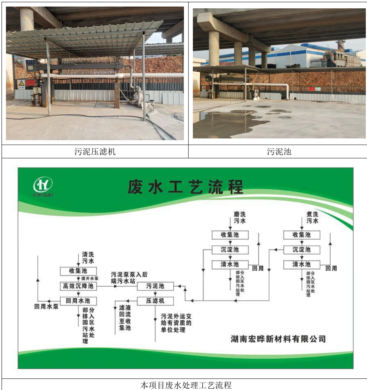
图 4.1-1 项目废水处理设施照片
