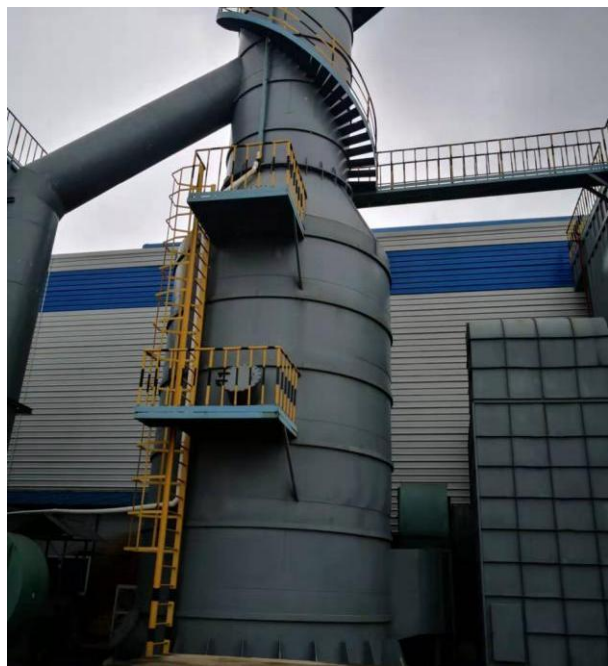
熔炼：碱液喷淋装置
