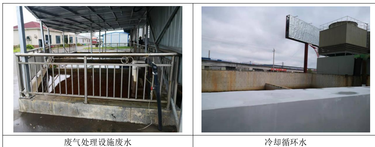
图 4.1-1 项目废水处理设施照片
