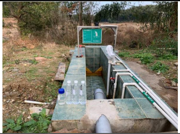
废水出口采样照片
