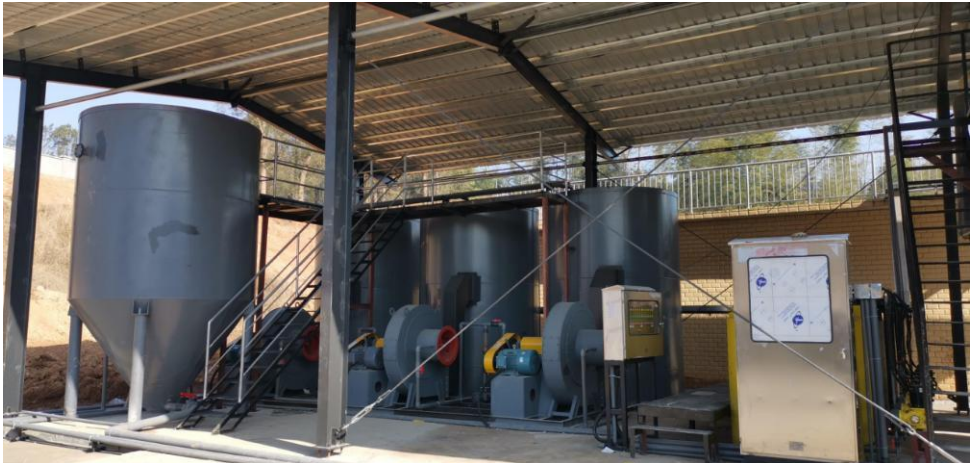
污水处理设施
