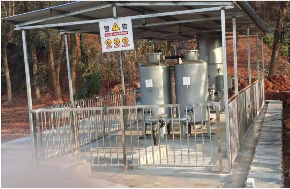
火炬燃烧装置
