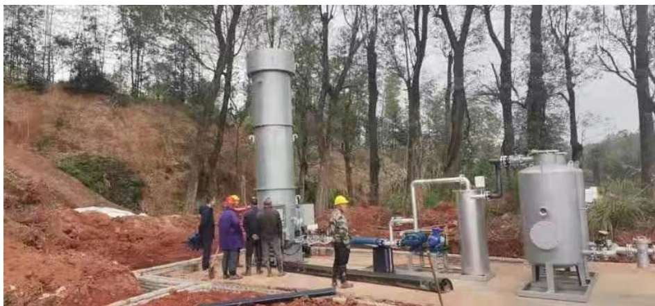
火炬燃烧装置
