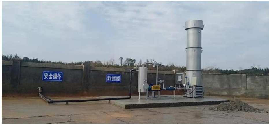
火炬燃烧装置
