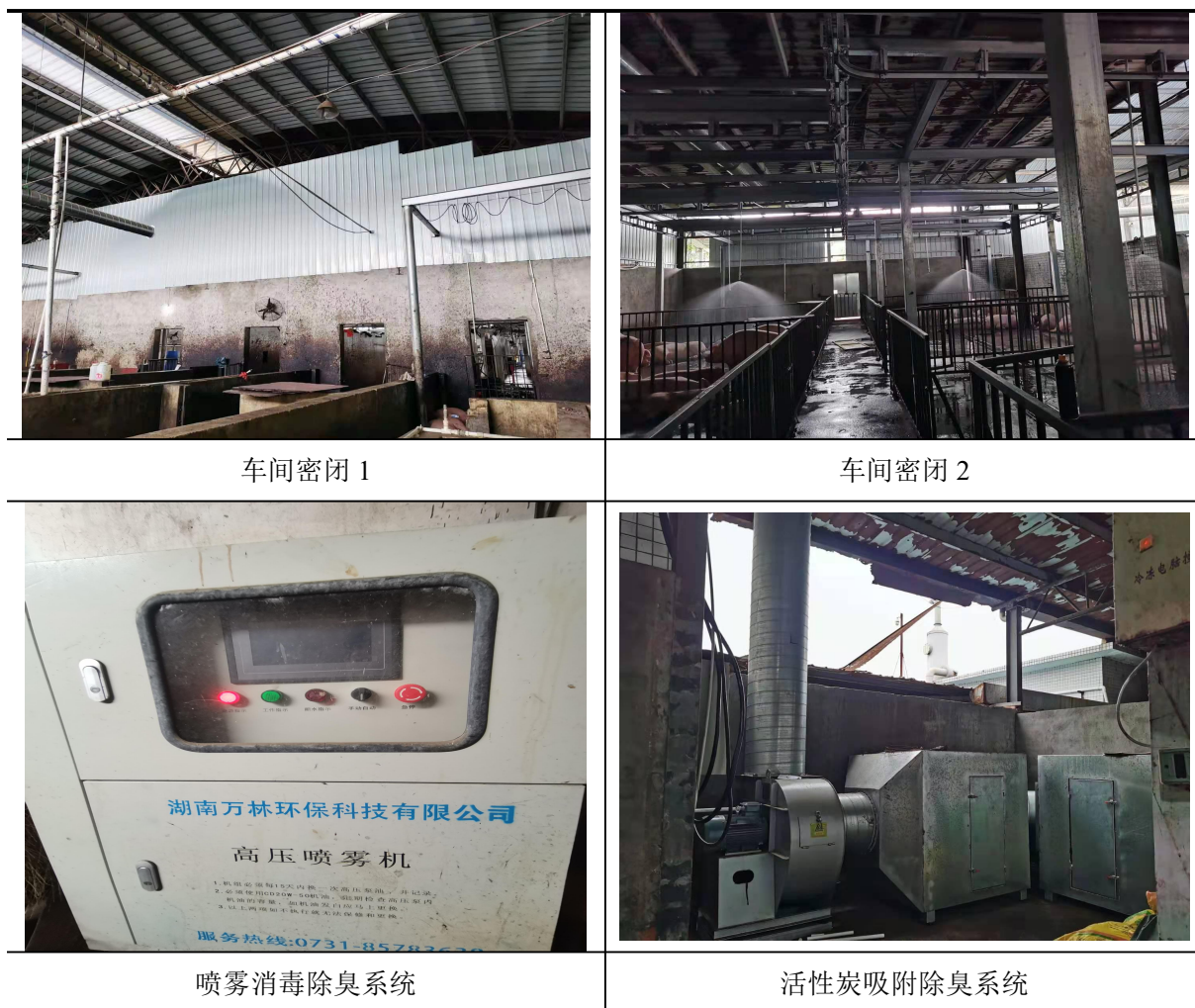
图 4-2 废气处理设施照片
