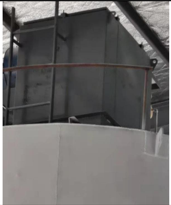
成品仓除尘器
