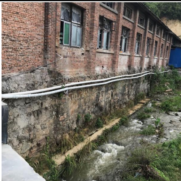
生产废水管道
