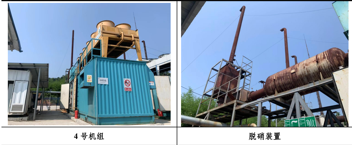
图 4-2 废气处理设施照片
