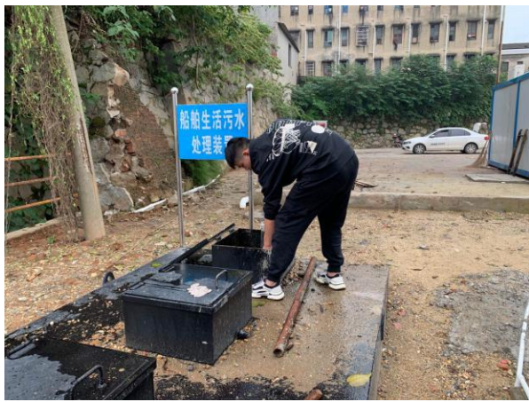
污水处理设施进口
