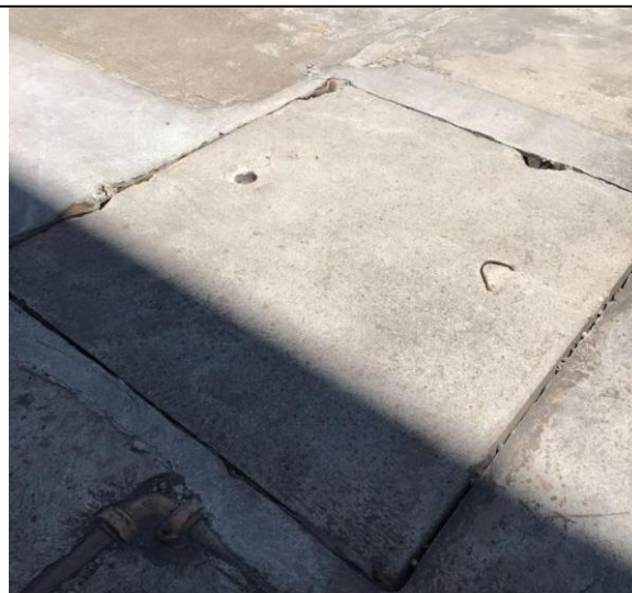
地面冲洗废水沉淀池
