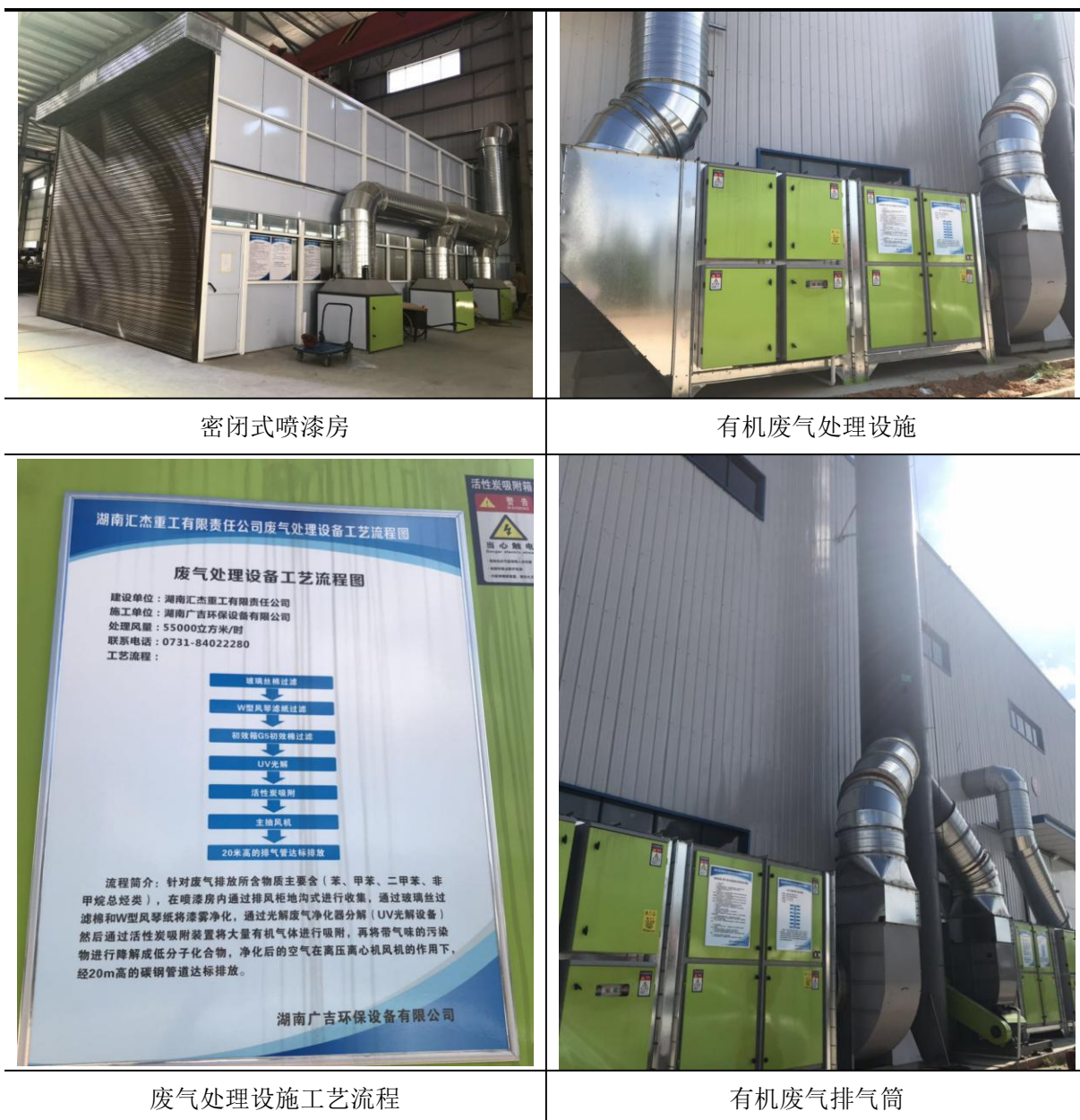
图 4-2 废气处理设施照片
