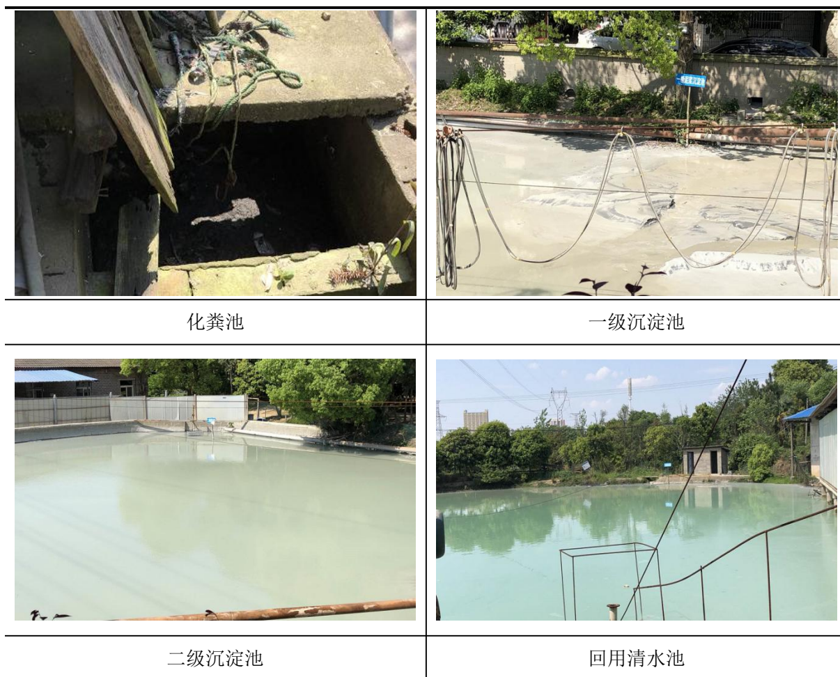
图 4-1 废水处理设施照片
