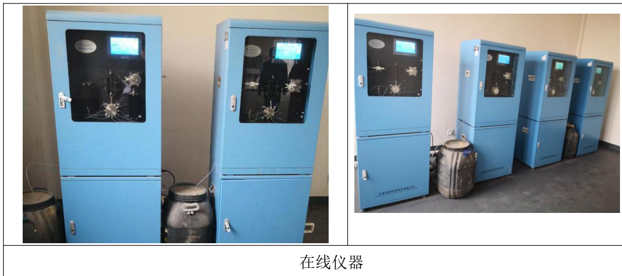
图 4.1-3 项目在线设施照片
