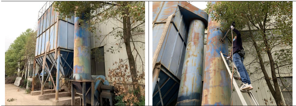
布袋除尘设施
