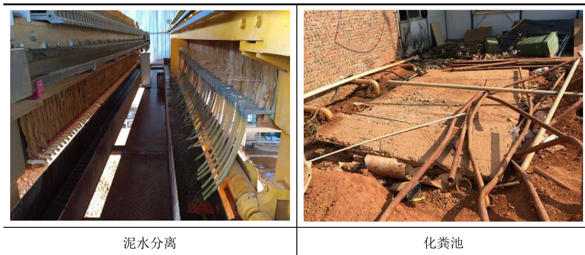
图 4-1 废水处理设施照片
