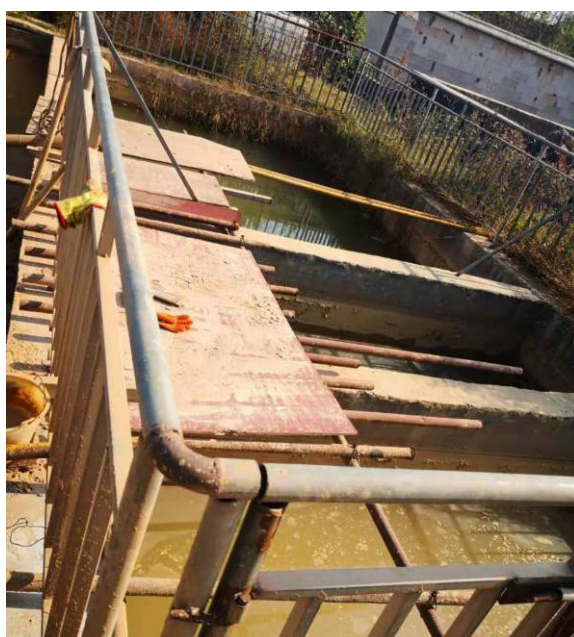
洗车废水三级沉淀池
